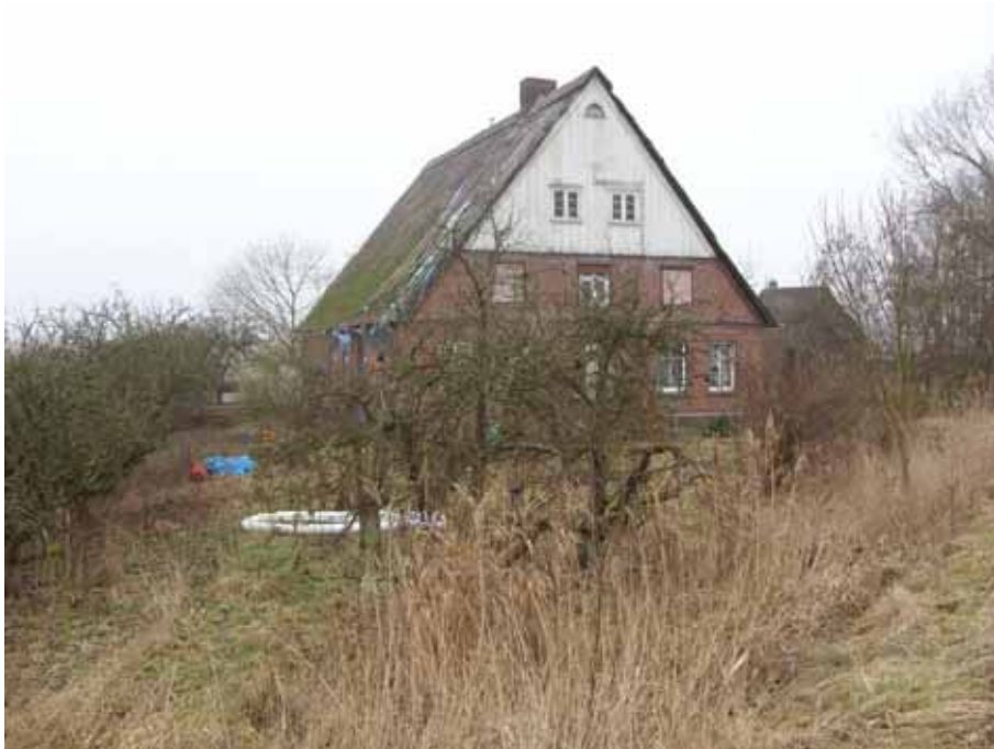
... für manches Objekt läuft jedoch die Zeit ab (desolates Bauernhaus in Neuland - wirtschaftlich nicht mehr zu sanieren)
