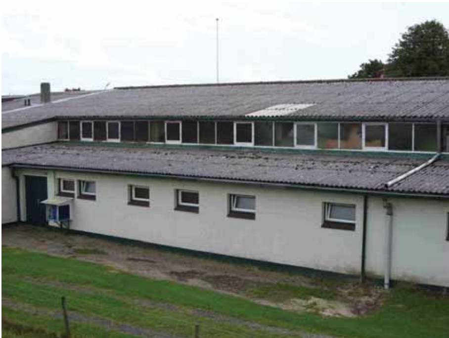
Aufgrund des desolaten Zustandes der Dachhaut ist eine dringende Erneuerung der Dachfläche (einschließlich Unterkonstruktion und Verbesserung der Dränung) nach Stand der Technik erforderlich!
