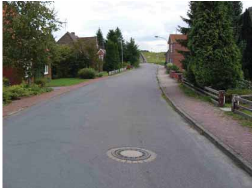
Fährstraße - Erneuerung der Gehwegenanlagen erforderlich!
