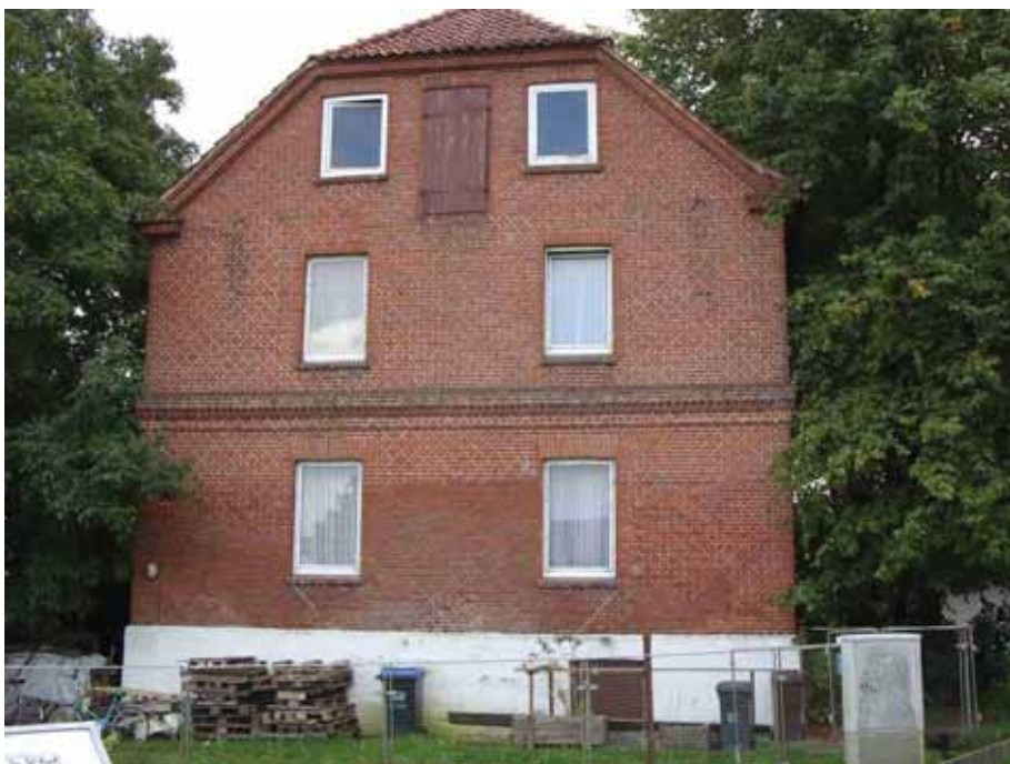
Altes Zollhaus im Bereich „Mehrzweckhalle“ - stattlicher Mauerwerksbau (Instandhaltungsmaßnahmen erforderlich)
