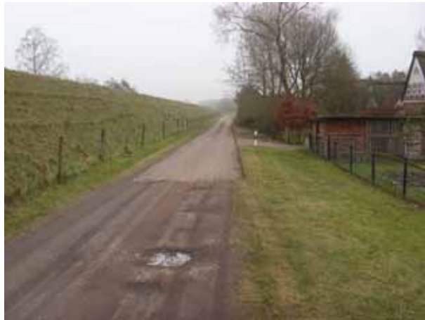
„Alter Deichweg“ (ehemalige Ortsdurchfahrt Neuland) - ortsgerechter Ausbau als Pflasterstraße wünschenswert.
